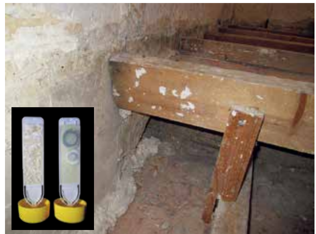
Mikrobiongelmat johtuvat usein kosteudesta.
